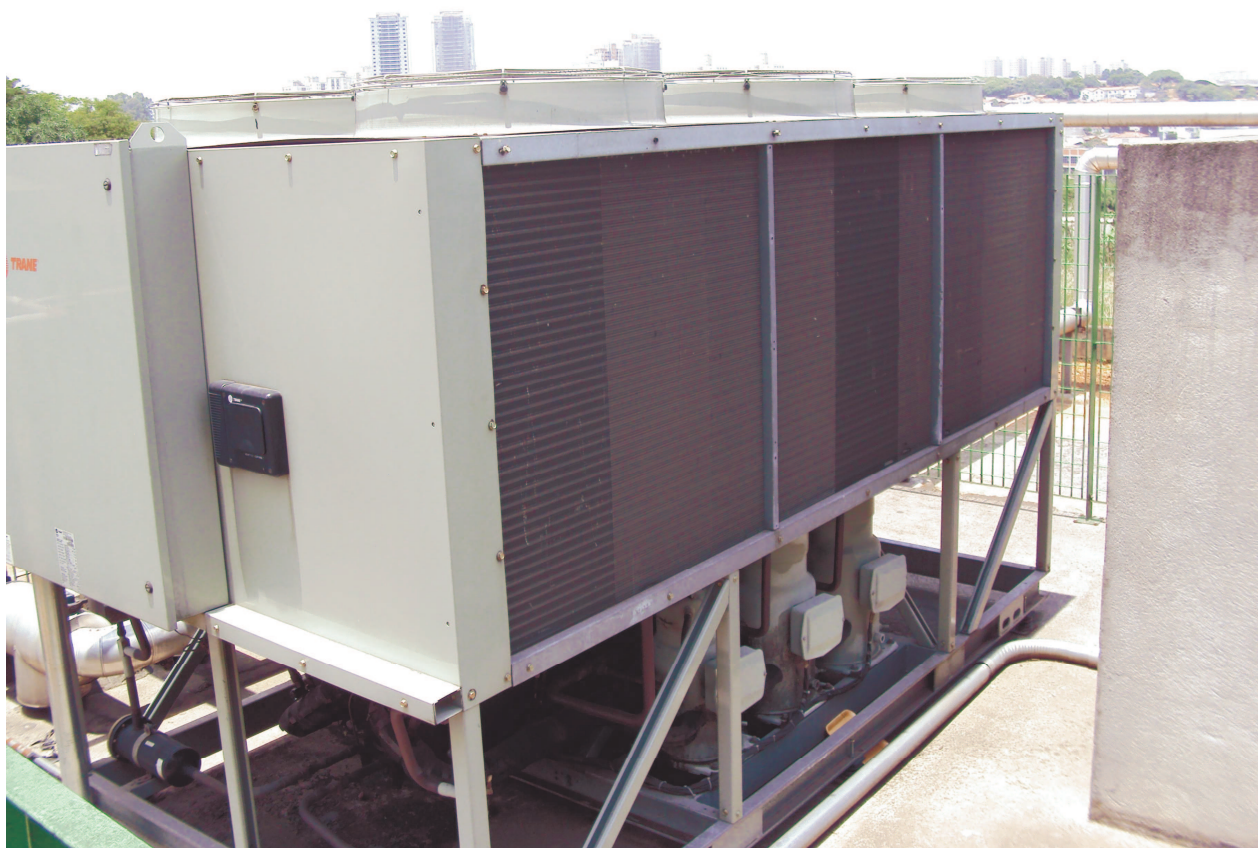
Figura 23: Chiller de compressão de 70 TRs
